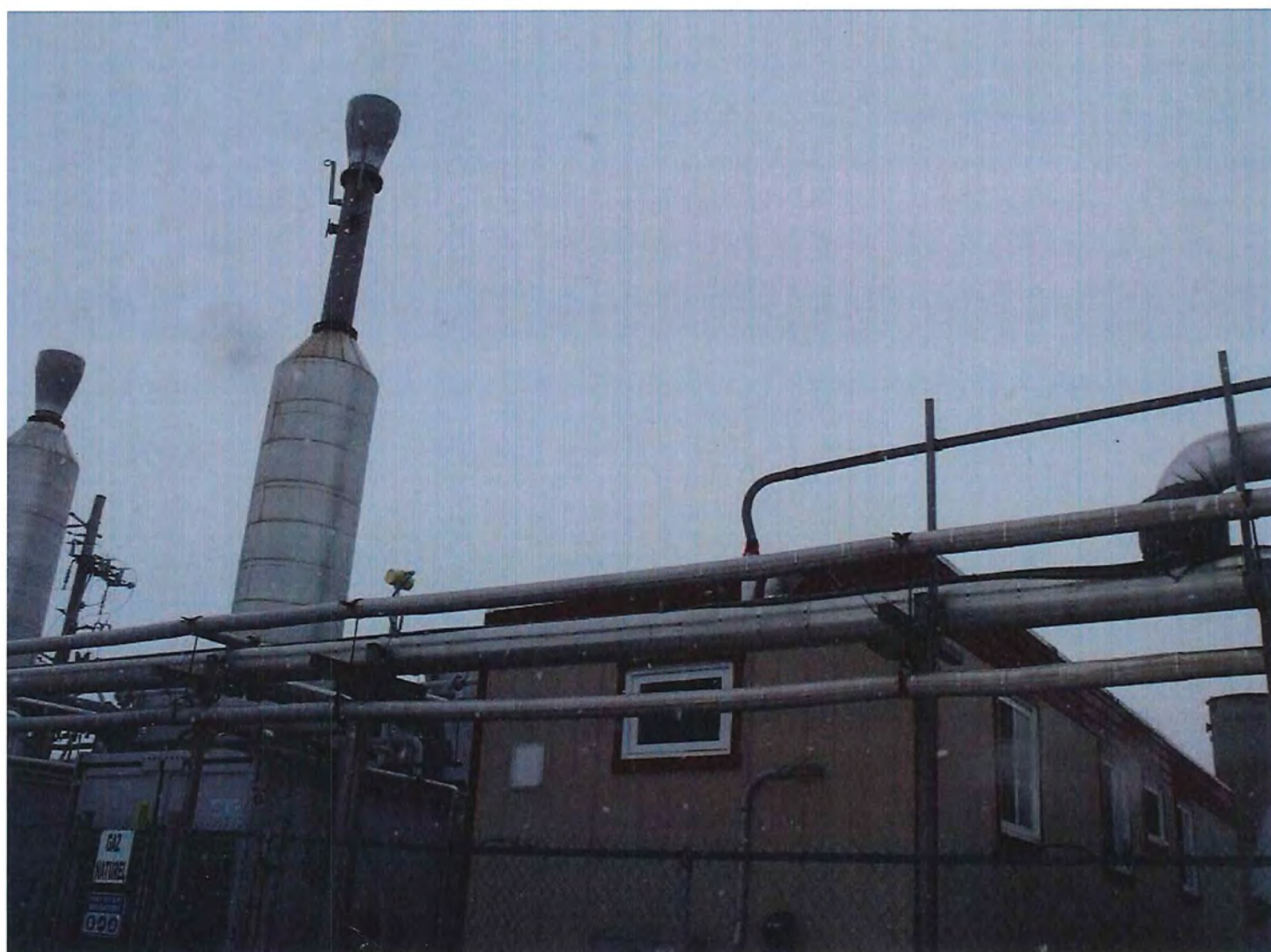
DSCF8491.JPG N°2 : Cheminées des moteurs de la cogénération
