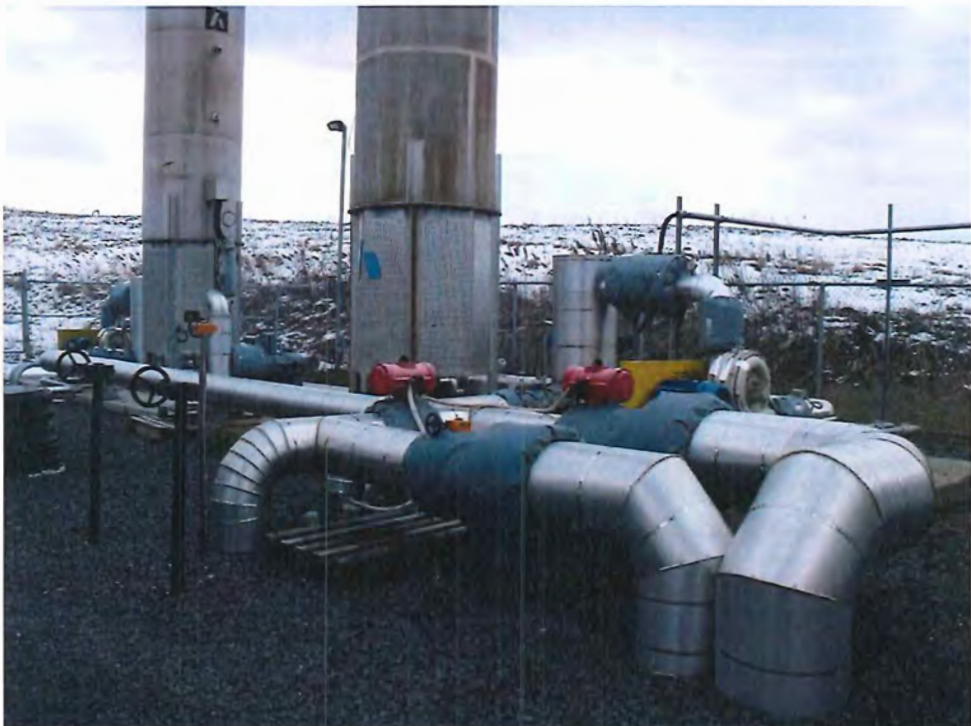
DSCF7519.JPG 2 torchères opérationnelles avec système de distribution des biogaz
