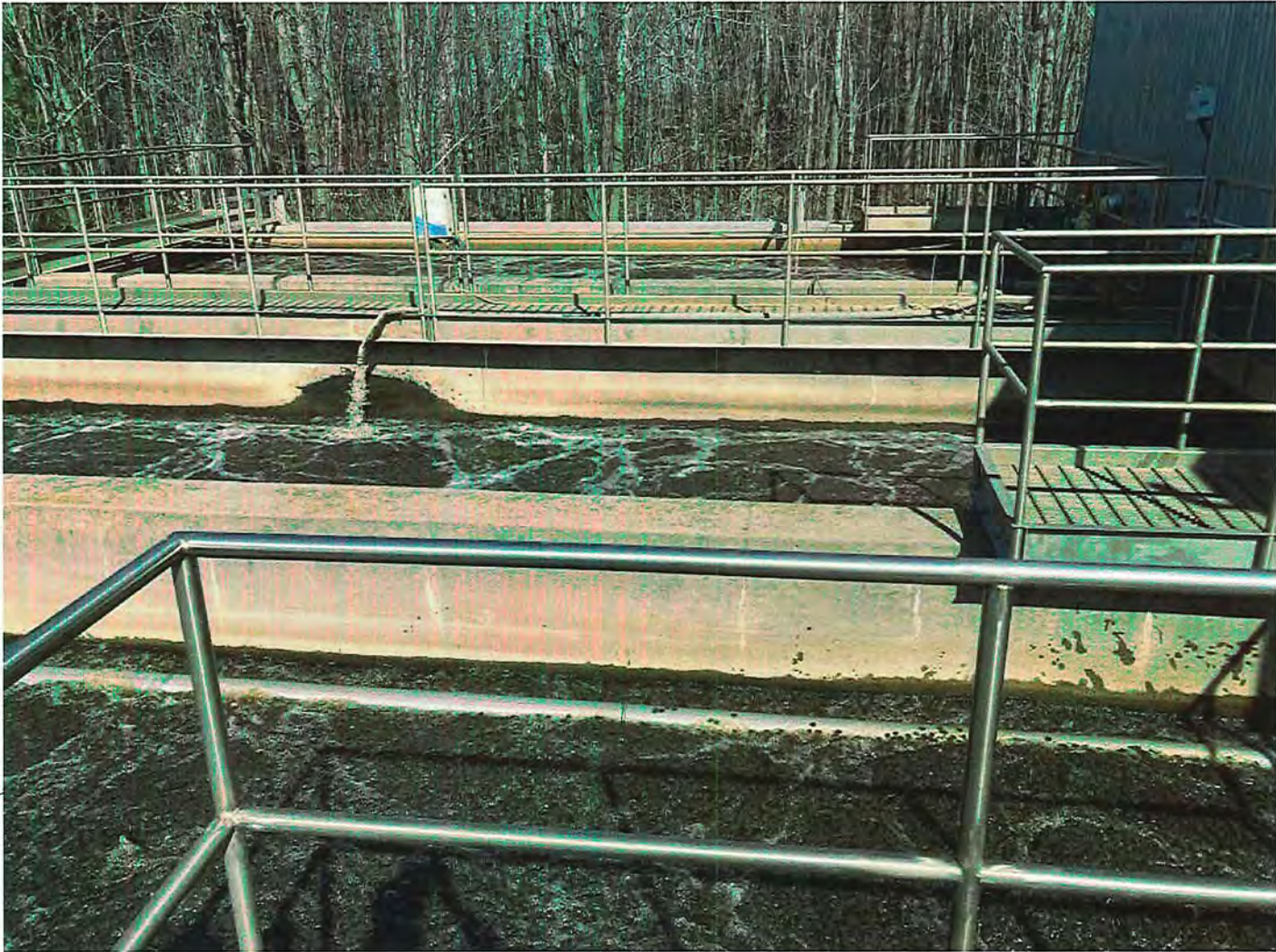
IMG_0338.JPG Photo 2. Bioréacteur de l'usine de traitement du lixiviat.
