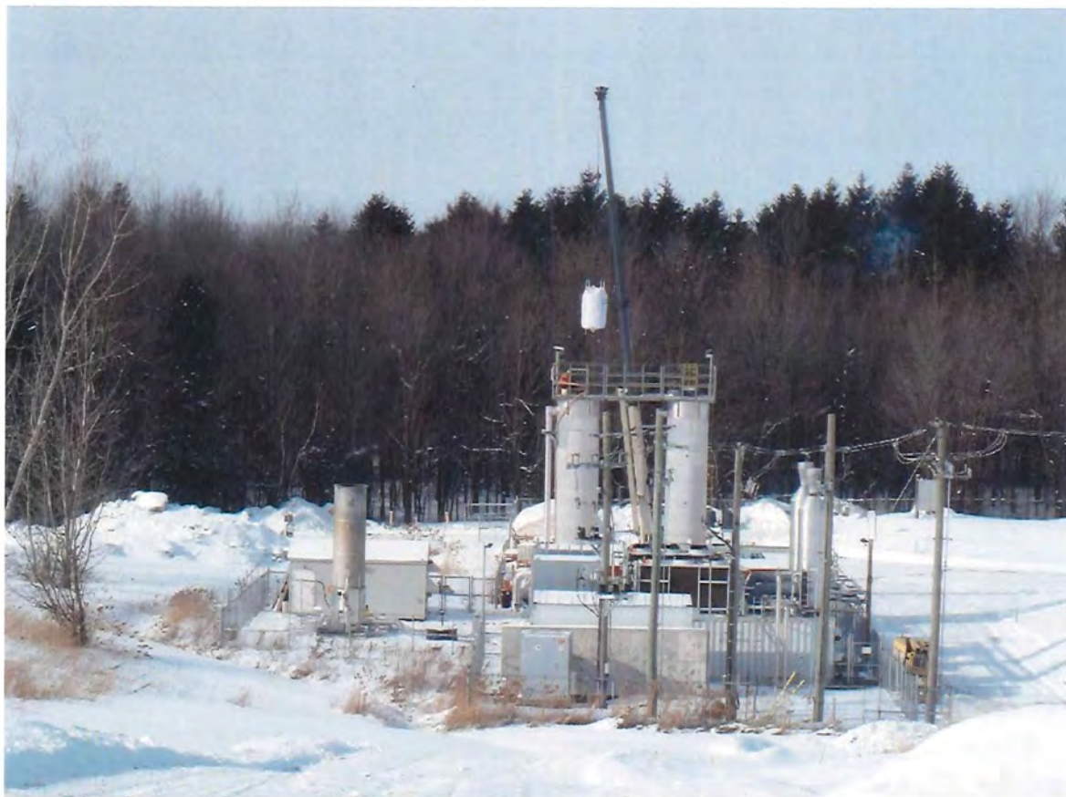
DSCF4078.jpg – Photo N2 : Centrale de cogénération
