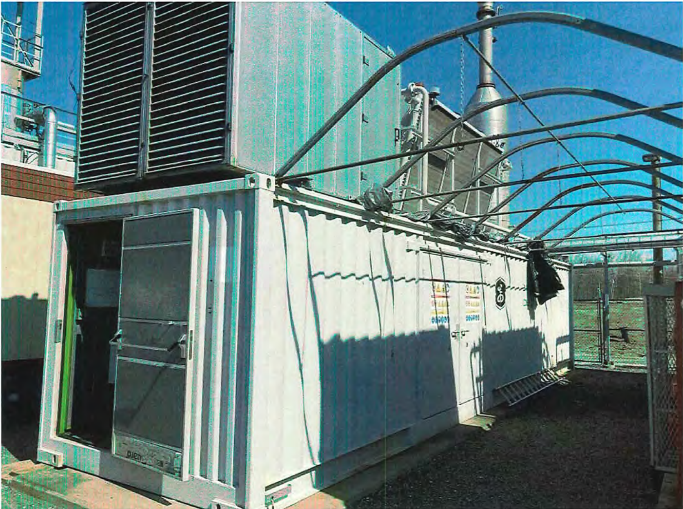
IMG_0349.JPG Photo 4. Conteneur renfermant les réacteurs de la central de cogénération.
