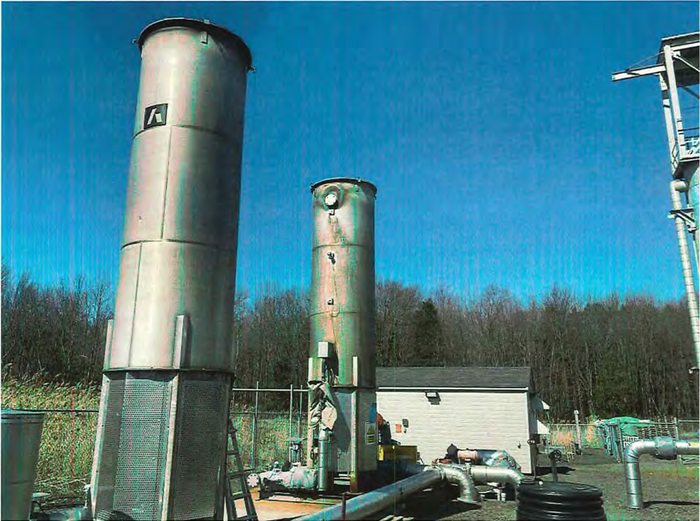
IMG_0350.JPG Photo 5. Torchères présent sur le site qui sont en soutien aux réacteurs
