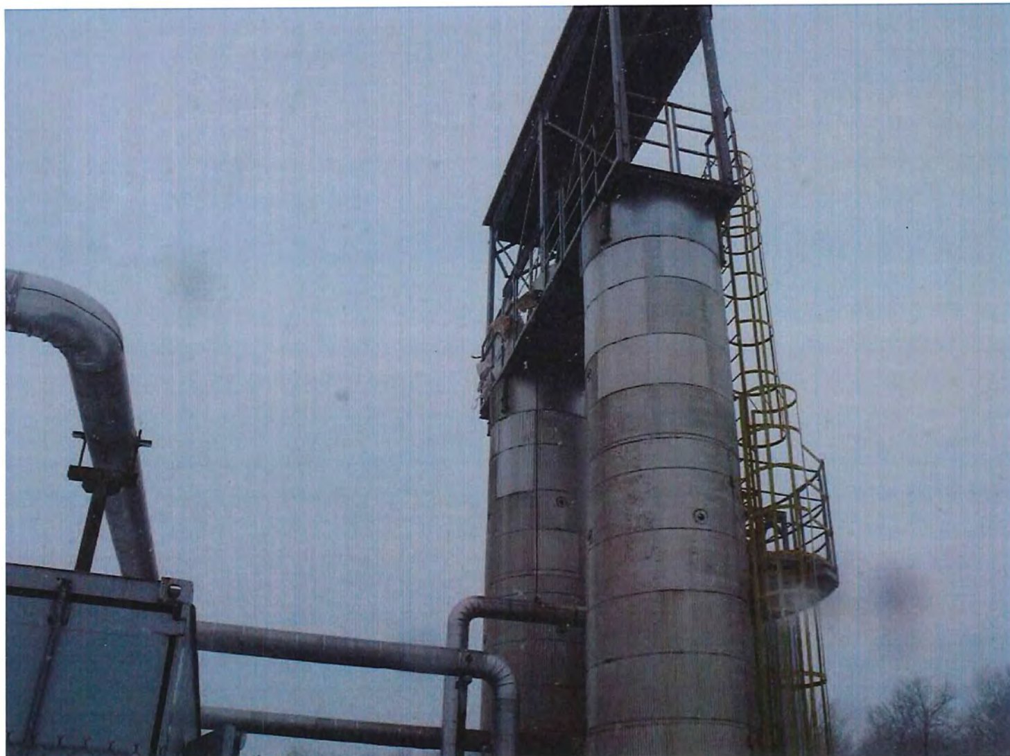
DSCF8490.JPG N°1 : Filtres pour réduction du H2S
